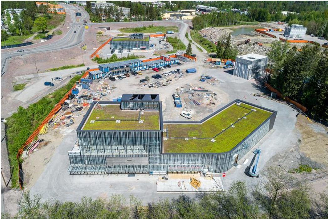
Kuva 7-2. Kaikille uusille Länsimetron asemille, joilla on omat sisäänkäyntirakennukset, rakennetaan viherkattoja. Viherkattoja rakennettiin vuonna 2021. Kuvassa näkyvät Finnoon metroaseman Meritien ja Finnoonsillan sisäänkäyntirakennusten katot. Kuva: Iiro Mikola, Optivision Oy.
