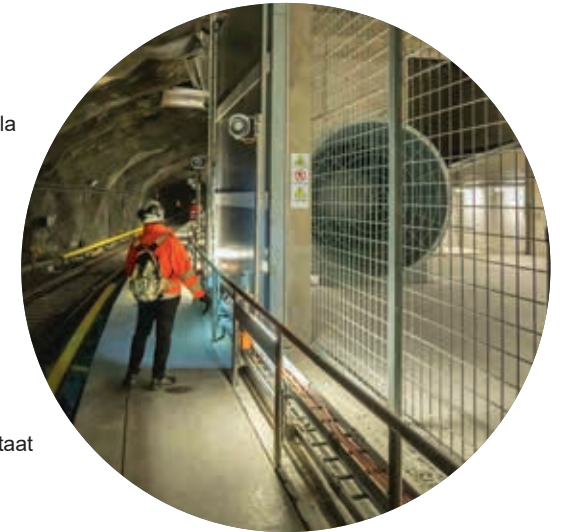
Savunpoisto käynnistyy automaattisesti tulipalotilanteissa.
